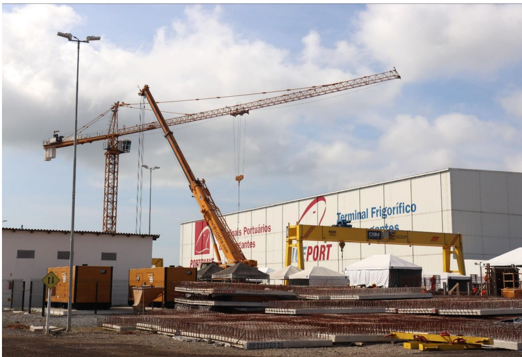
Equipamentos elétricos para fabricação dos pré-moldados
